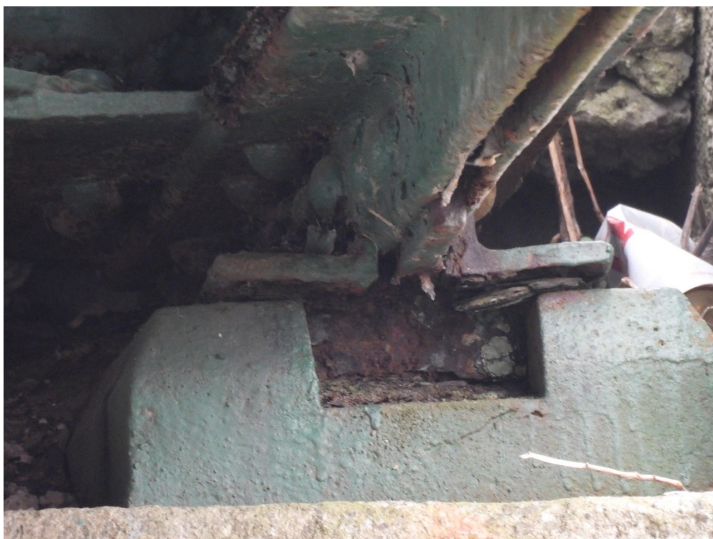
Fot. 12. Łożyska na podporze południowej - zanieczyszczenia, korozja.
