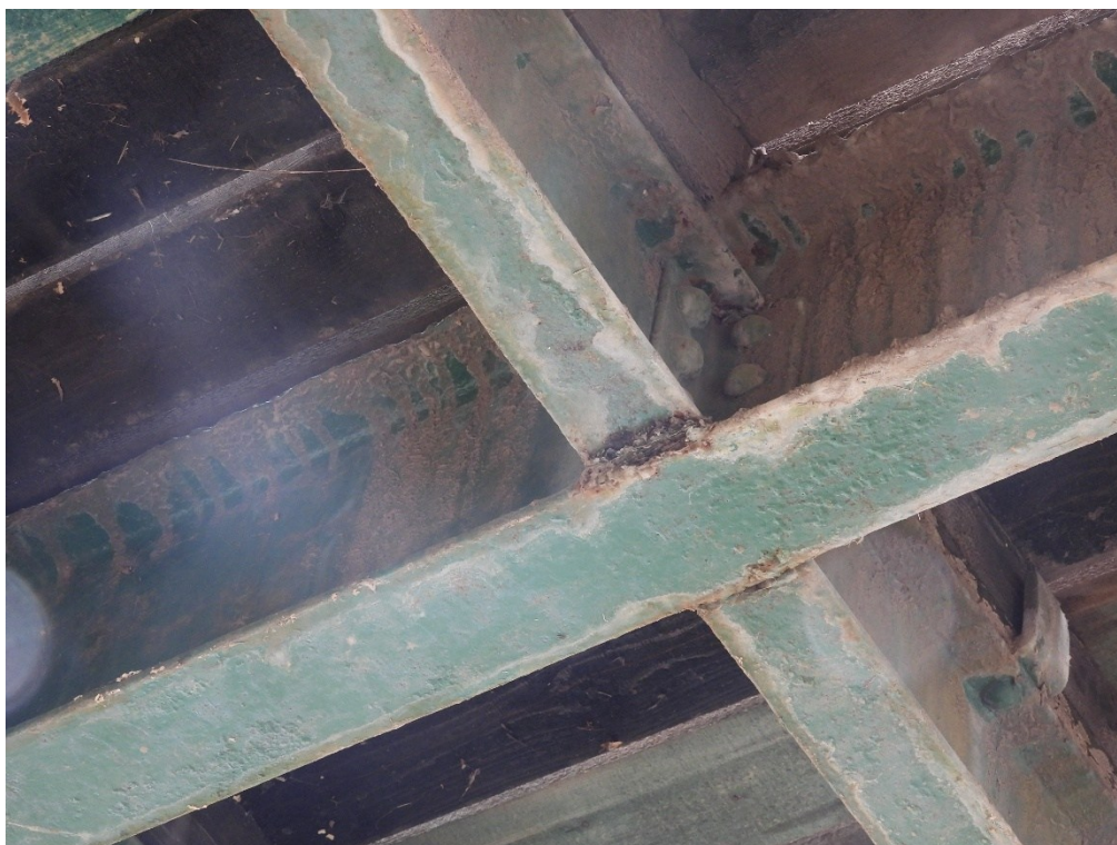
Fot.5. Ruszt przęsła – zanieczyszczenia, zacieki.
