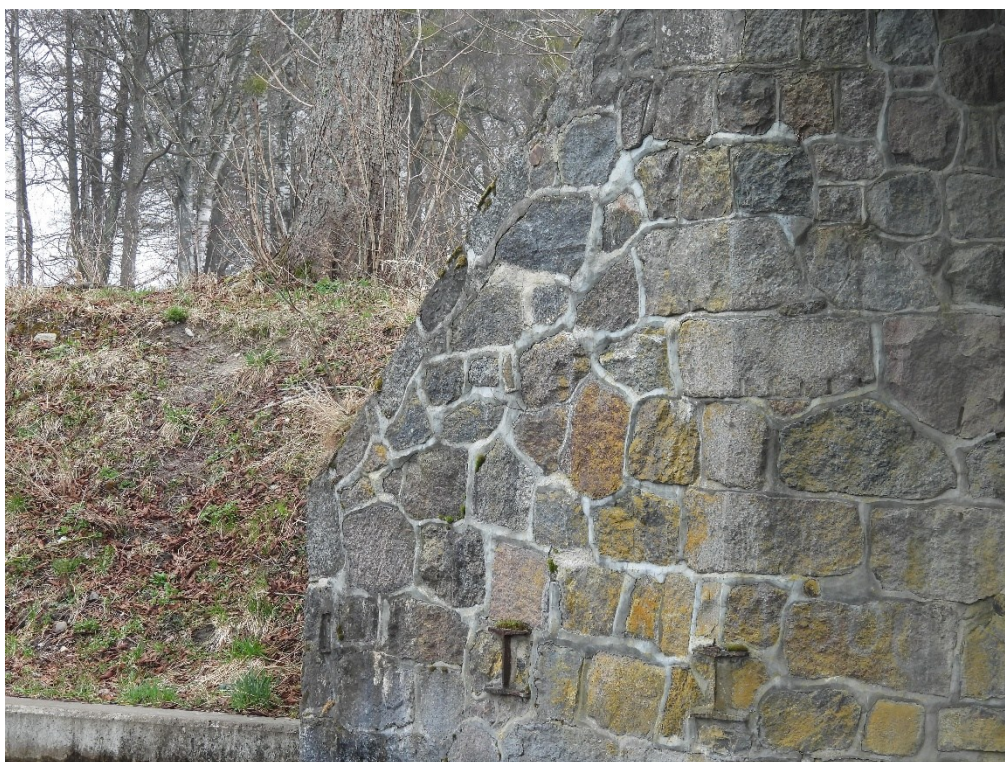
Fot. 22. Podpora południowa – rozluźnienia i ubytki spoin, wegetacja roślin.
