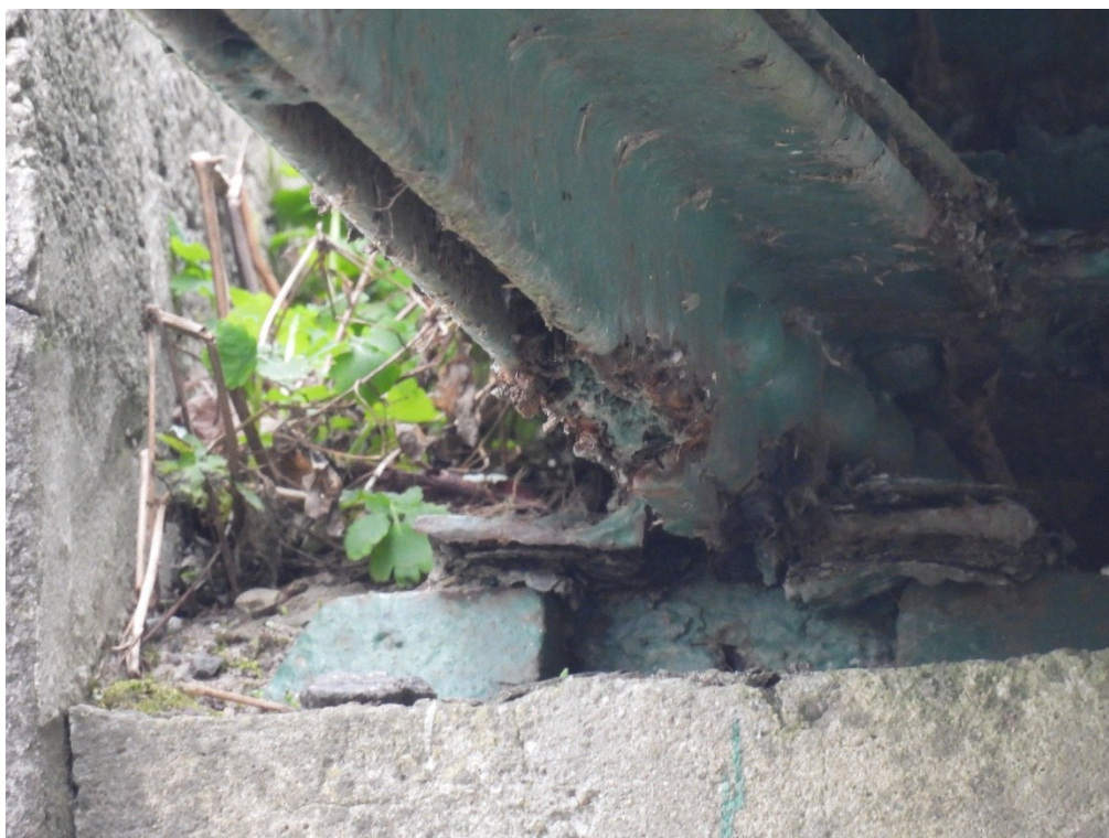
Fot. 10. Łożyska na podporze południowej – zanieczyszczenia, korozja.
