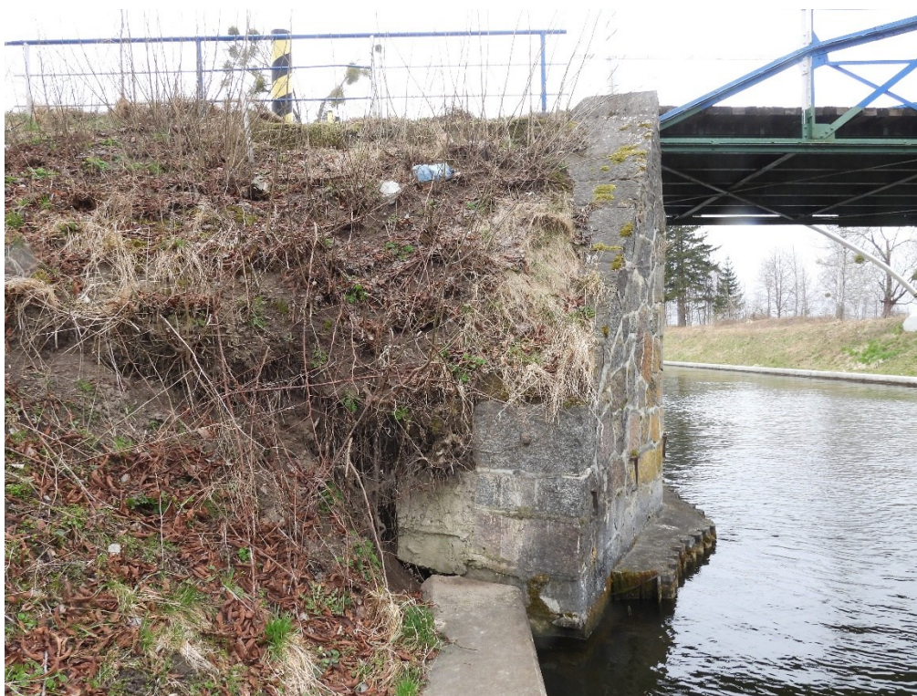
Fot. 39. Skarpa za skrzydłem północno-wschodnim - wegetacja roślin, osunięcie mas za skrzydłem.
