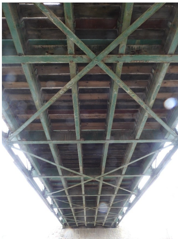
Fot.3. Przęsło – widok od spodu, lokalne zniszczenia powłok antykorozyjnych i korozja, zanieczyszczenia na pasach poziomych kształtowników.
