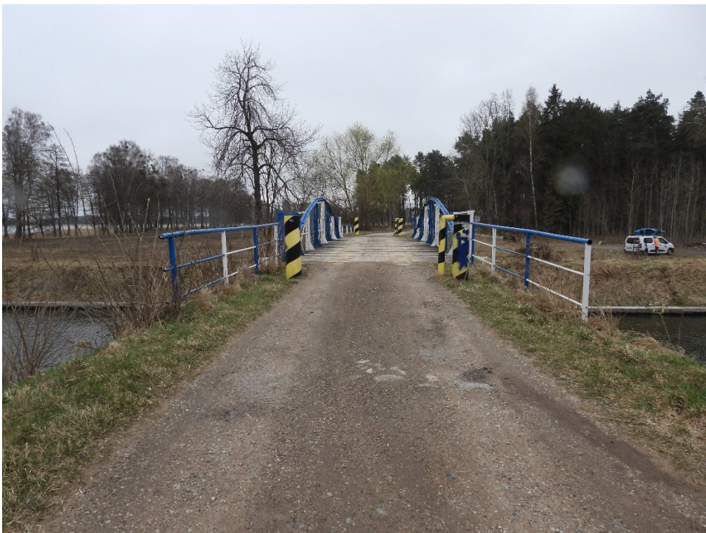
Fot. 26. Dojazd do obiektu od strony północnej – widoczne słupy ograniczające szerokość jezdni, ubytki zanieczyszczenia i deformacje (koleiny) nawierzchni na dojeździe.
