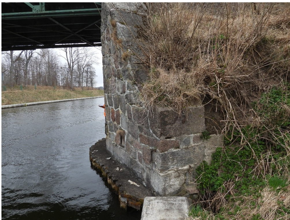
Fot. 40. Skarpa za skrzydłem południowo-zachodnim - wegetacja roślin, osunięcie mas ziemnych.
