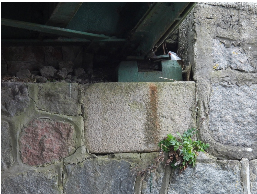
Fot. 11. Łożyska na podporze południowej - zanieczyszczenia, korozja.
