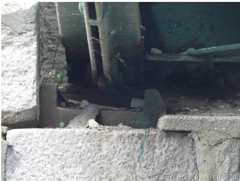
Fot. 13. Łożyska na podporze północnej - zanieczyszczenia, korozja.
