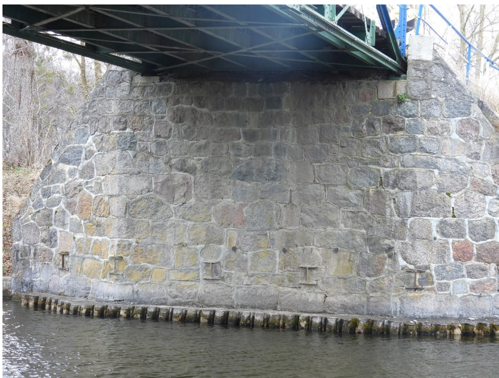
Fot. 20. Podpora południowa – rozluźnienia i ubytki spoin, wegetacja roślin.
