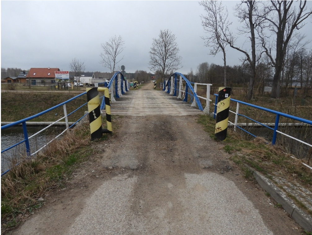
Fot. 25. Dojazd do obiektu od strony południowej – widoczne słupy ograniczające szerokość jezdni, ubytki zanieczyszczenia i deformacje (koleiny) nawierzchni na dojeździe.
