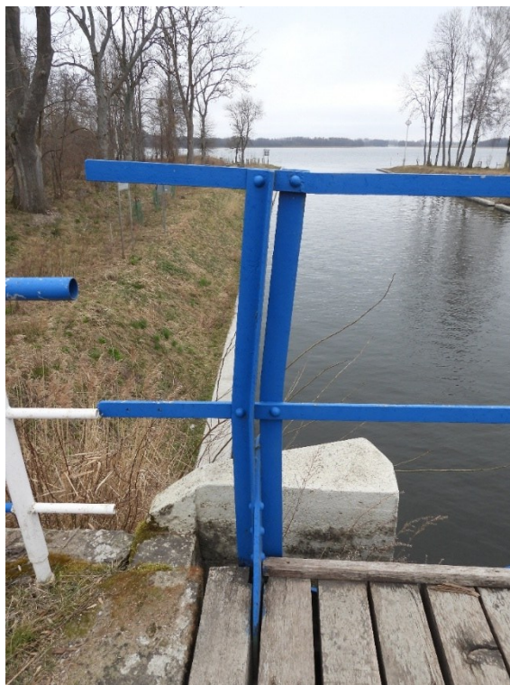
Fot. 31. Balustrady na obiekcie – zdeformowany słupek balustrady.
