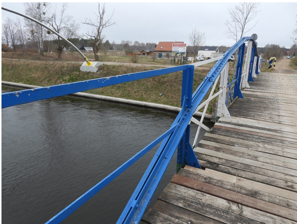
Fot. 32. Balustrady na obiekcie – brak spełnienia zaleceń WR-M dla balustrad, lokalne ogniska korozji i zmieszczenia powłoki malarskiej.
