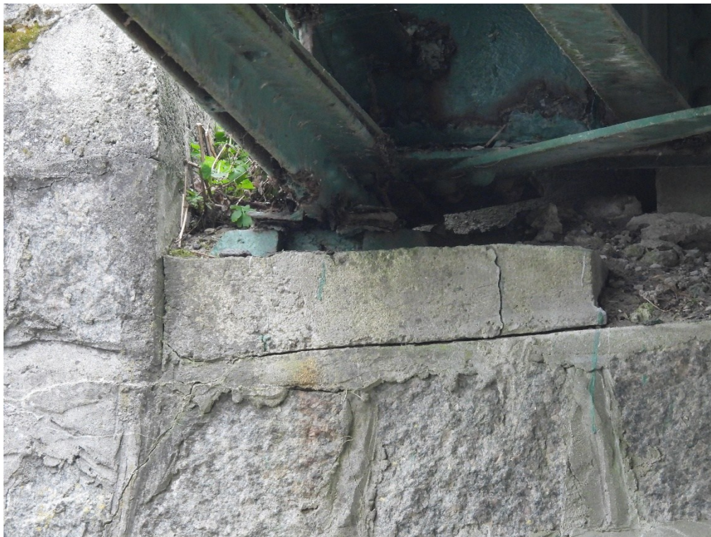
Fot. 9. Łożyska na podporze południowej – zanieczyszczenia, korozja, pęknięcie ciosu podłożyskowego.
