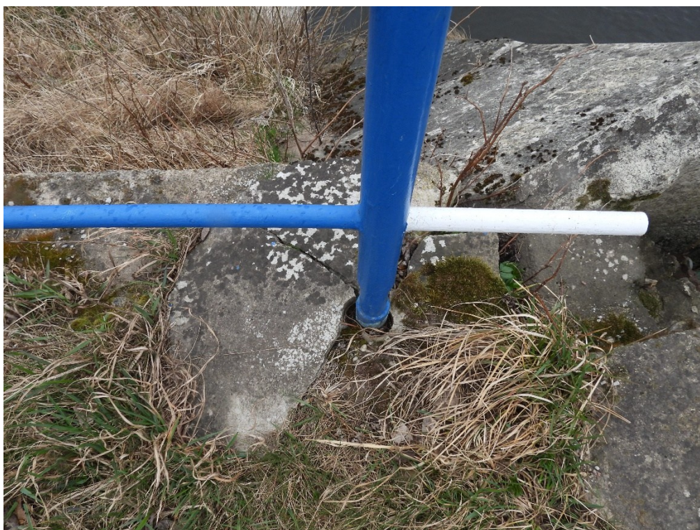
Fot. 35. Balustrady poza obiektem – uszkodzenia mocowania słupka w ławie.
