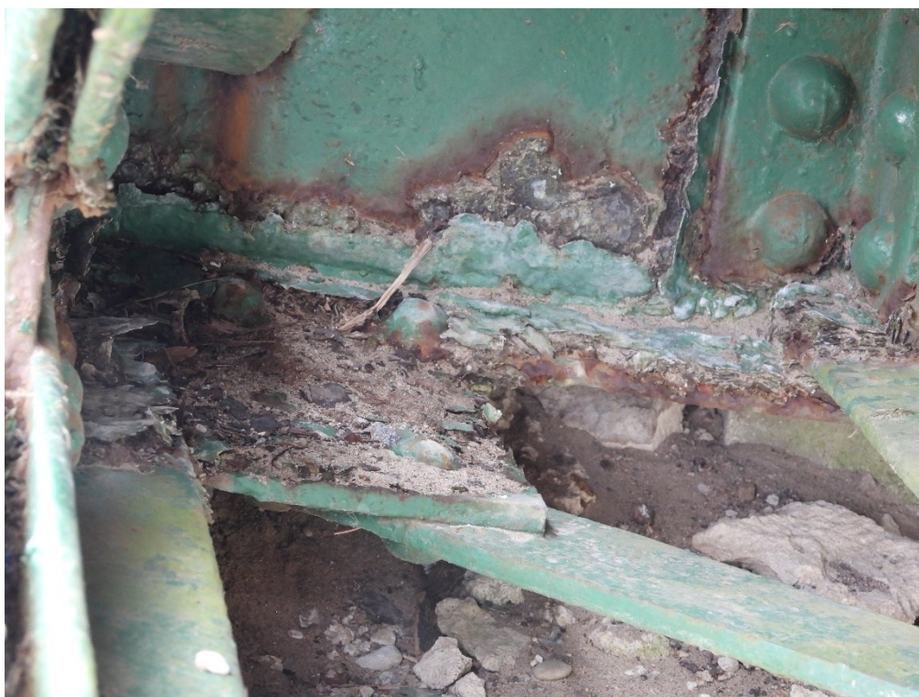
Fot.6. Węzeł nad łożyskiem – silna korozja z pęcznieniem i odspojeniem produktów korozji, zanieczyszczenia.
