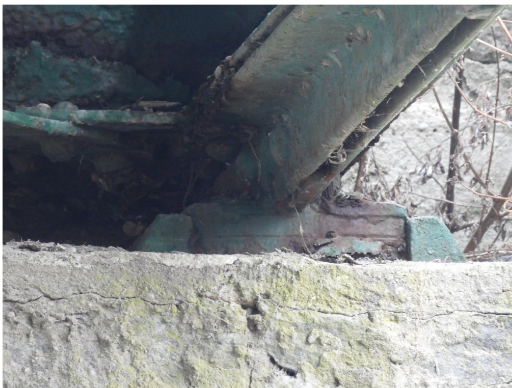
Fot. 14. Łożyska na podporze północnej – zanieczyszczenia, korozja.
