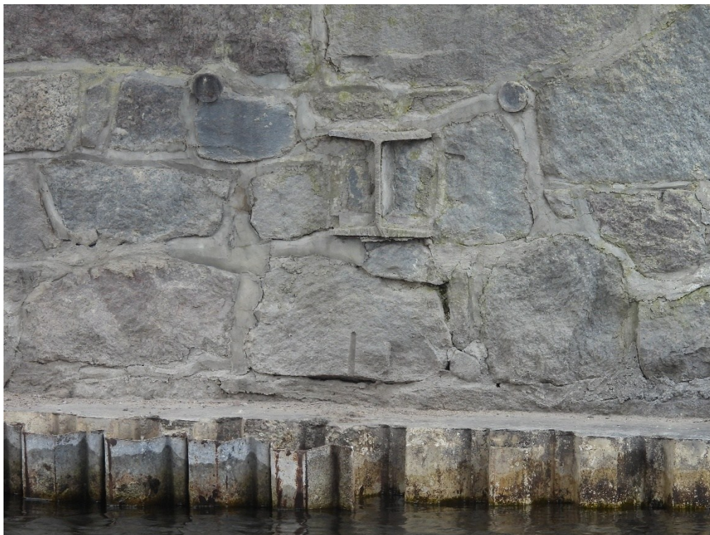
Fot. 16. Podpora północna – odspojenia i brak grodzic, ubytki i odspojenia wypełnień spoin.
