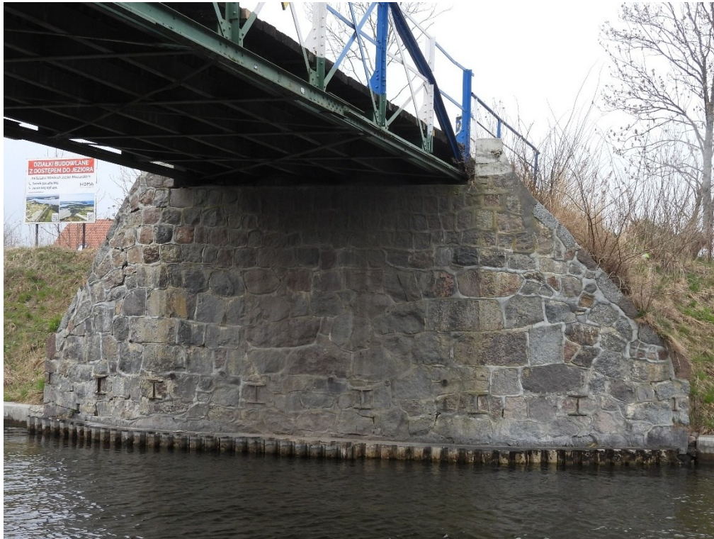
Fot. 15. Podpora północna – rozluźniania i ubytki wypełnień spoin, odspojenie grodzic od części betonowych podpór oraz braki grodzic w części przy skrzydle i fragmencie podpory.
