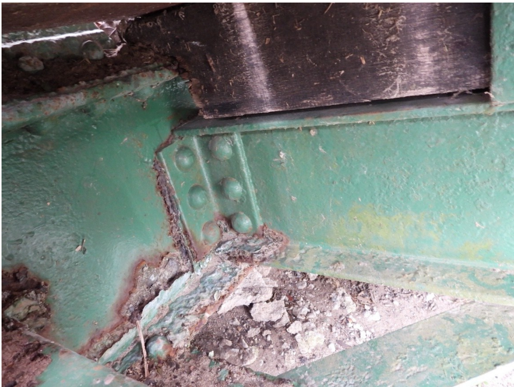
Fot.8. Poprzecznicą skrajną - silna korozja z pęcznieniem i odspojeniem produktów korozji, zanieczyszczenia.
