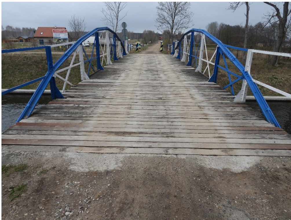
Fot. 23. Nawierzchnia na obiekcie – korozja desek, koleiny, wytarcia od kół pojazdów.
