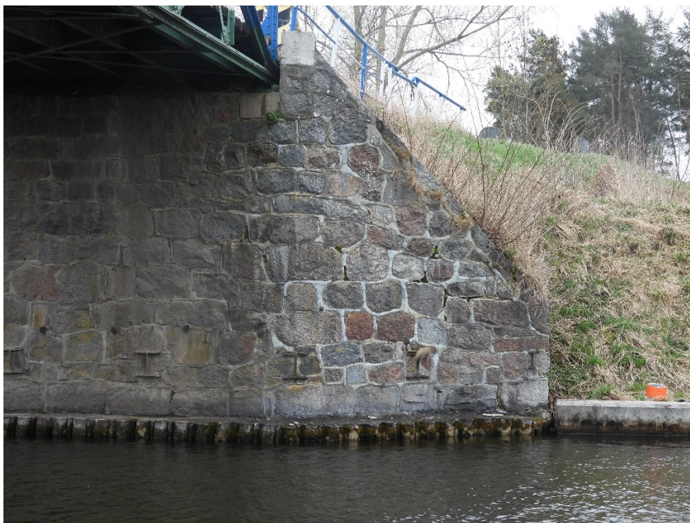
Fot. 21. Podpora południowa – rozluźnienia i ubytki spoin, wegetacja roślin.
