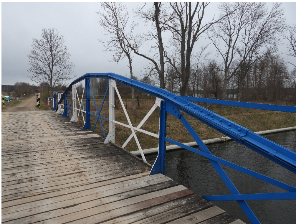
Fot. 30. Balustrady na obiekcie – brak odpowiedniego wypełnienia zabezpieczającego przed spadnięciem, brak spełnienia zaleceń WR-M dla balustrad, lokalne ogniska korozji i zmieszczania powłoki malarskiej.
