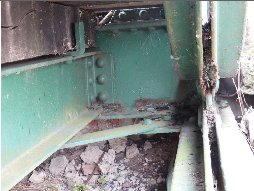
Fot.7. Węzeł nad łożyskiem – silna korozja z pęcznieniem i odspojeniem produktów korozji, zanieczyszczenia.
