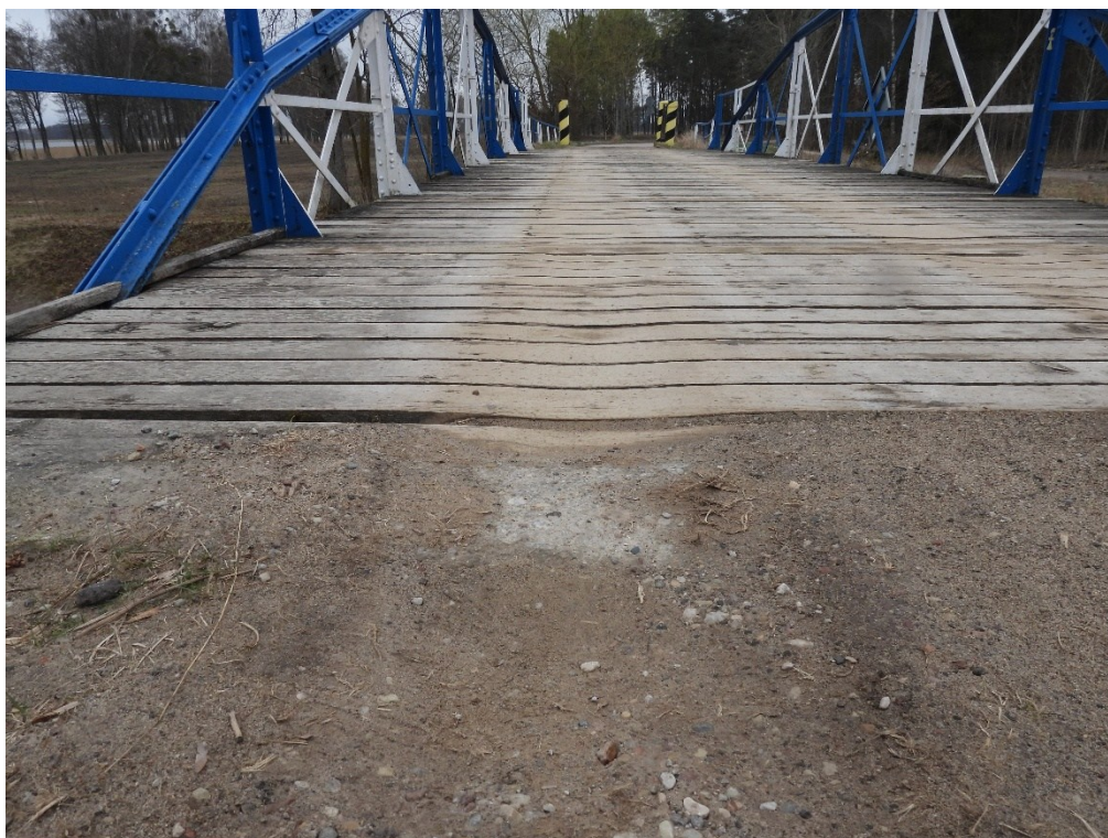
Fot. 24. Nawierzchnia na obiekcie – korozja desek, koleiny, wytarcia od kół pojazdów.
