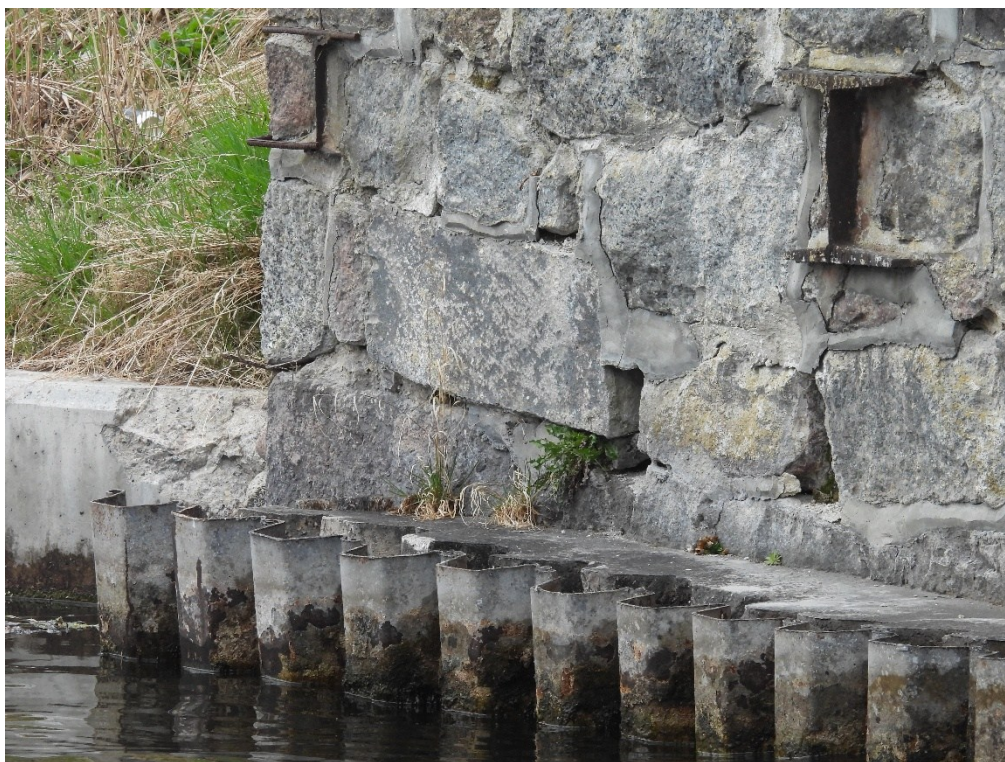
Fot. 19. Podpora północna – ubytki spoin, odspojenie grodzic, wegetacja roślin.
