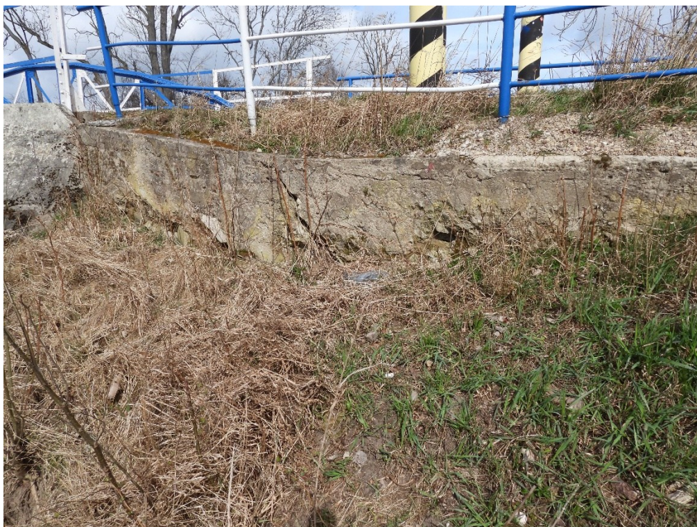
Fot. 34. Balustrady poza obiektem – spękana i zdeformowana ława pod balustradą.
