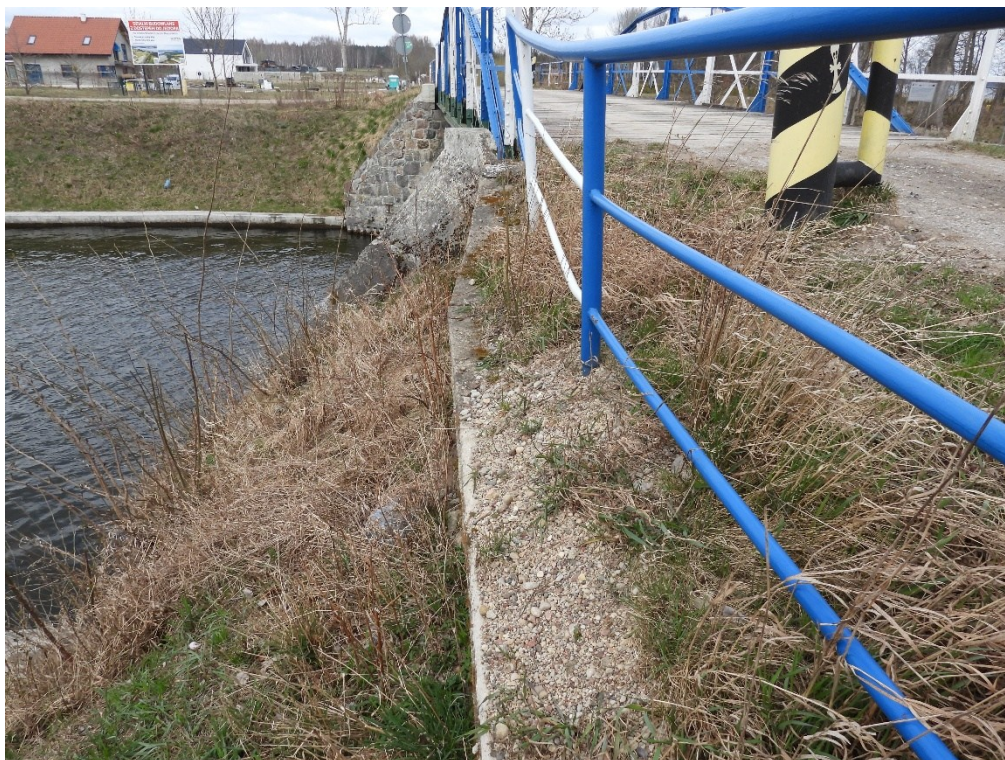
Fot. 33. Balustrady poza obiektem – spękana i zdeformowana ława pod balustradą.
