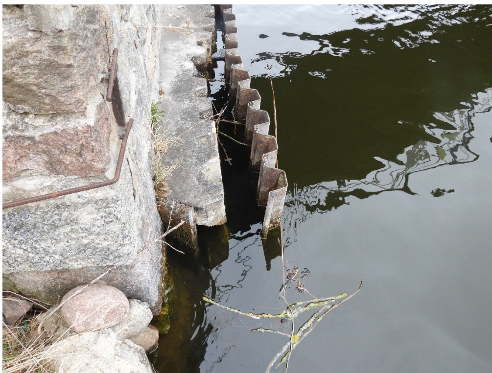
Fot. 18. Podpora północna – odspojenie grodzic od części betonowych podpór.
