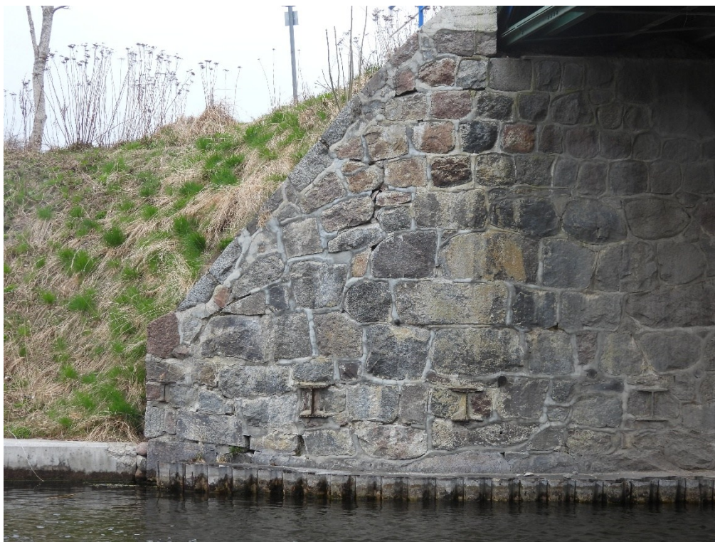
Fot. 17. Podpora północna – rozluźnienia i ubytki spoin, odspojenia grodzic.
