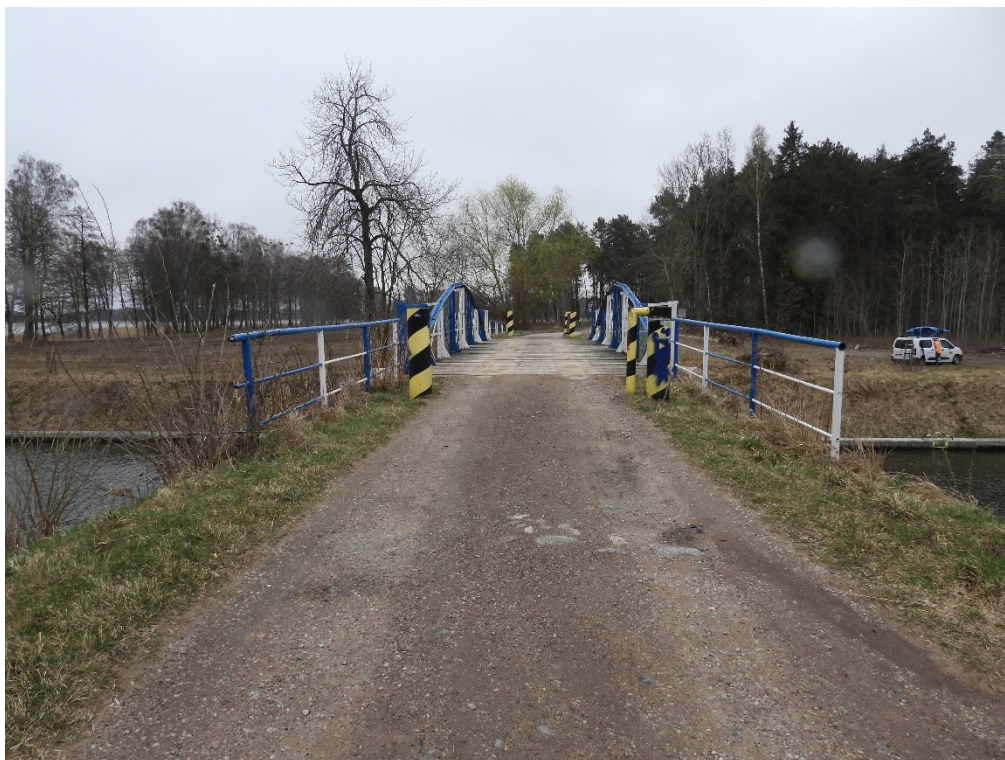
Fot. 37. Balustrady na dojeździe – brak spełnienia zaleceń WR-M, lokalne ogniska korozji i zmieszczenia powłoki malarskiej.
