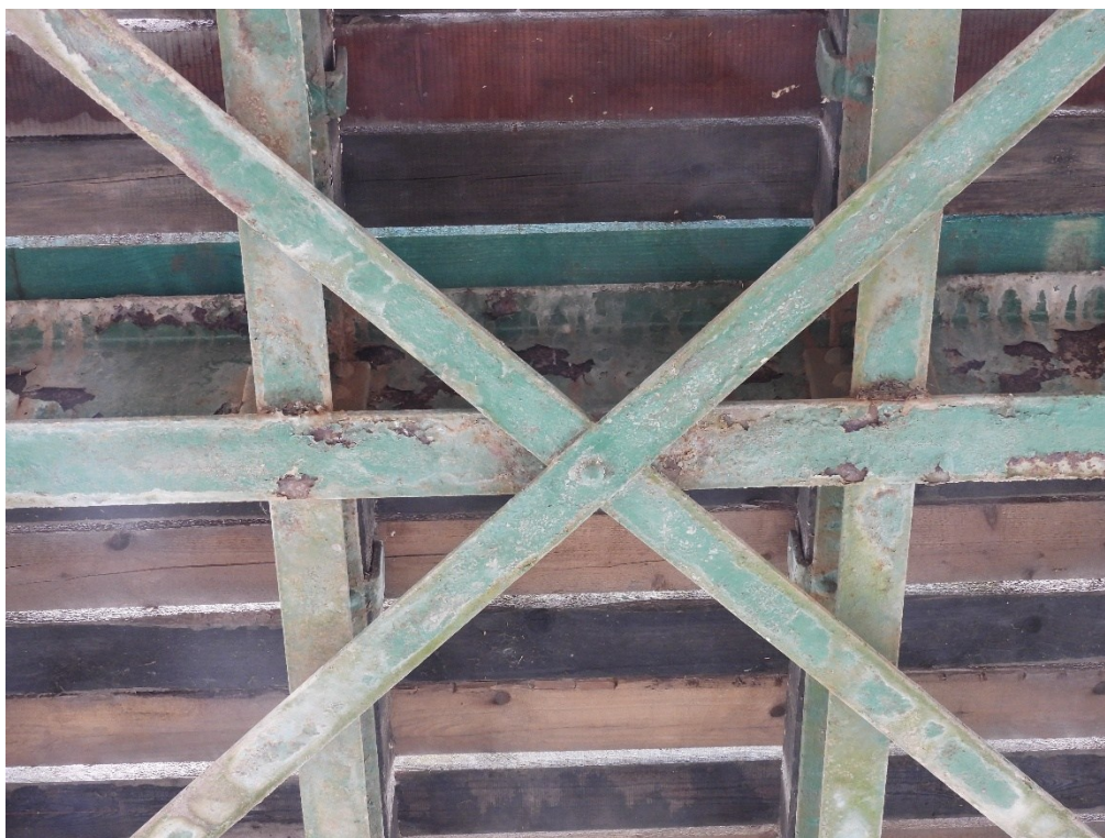
Fot.4. Ruszt przęsła – lokalne zniszczenia powłok malarskich i korozja, zanieczyszczenia i zacieki.
