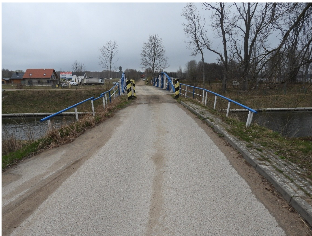
Fot. 36. Balustrady na dojeździe – brak spełnienia zaleceń WR-M, lokalne ogniska korozji i zmieszczenia powłoki malarskiej.
